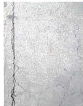
Foto 4: Piso de torta de concreto agretada
