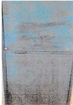
Foto 1: Puerta de modulo en mal estado 1 metro por 2.9 metros
