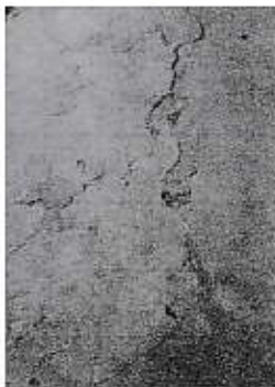
Foto 3: Piso de torta de concreto con hundimiento
