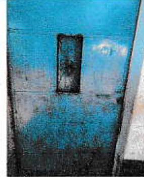
Foto 2: Puerta de salon de clases en mal estado medidas 1 metro por 2 metros
